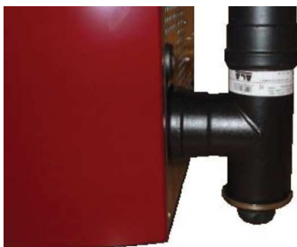
Fig. 21 - Fume conduit cleaning
